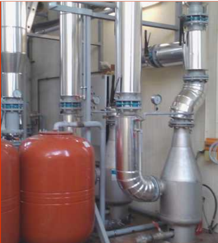
2 filtres HM 100 dans chaufferie
